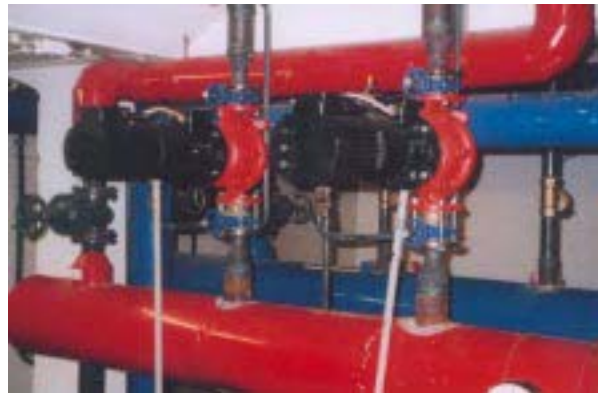
Abbildung 14: Neue drehzahlgeregelte Hauptpumpen.
