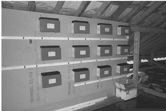
Abbildung 9: Montierte Wechselrichter im Dachstuhl des Aggertal-Gymnasiums Engelskirchen.
