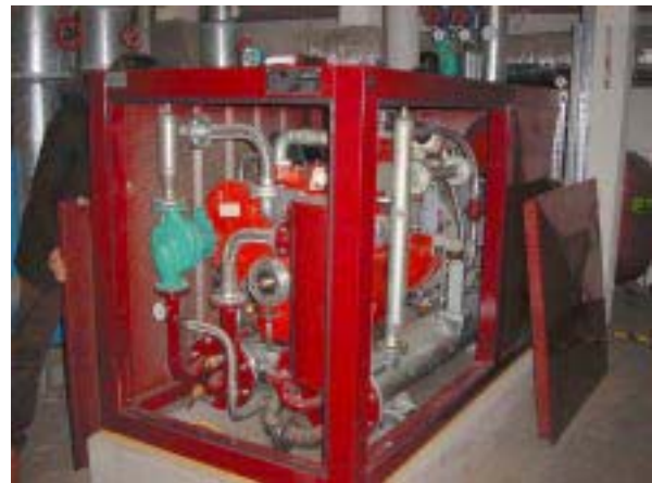
Abbildung 17: BHKW-Modul fertig installiert im Keller des ATG
