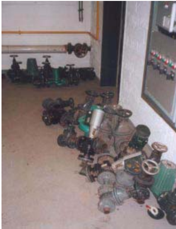
Abbildung 13 : Ausgebaute Umwälzpumpen und Armaturen (Hauptverteilung)
